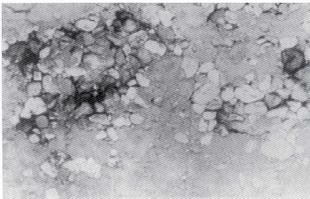
Fotografia 1.9 - Desgaste do concreto por abrasão
