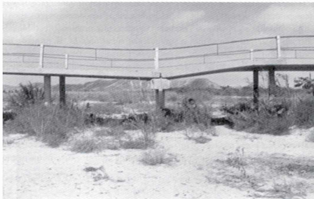
Fotografia 1.2 - Situação de recalque de fundação
