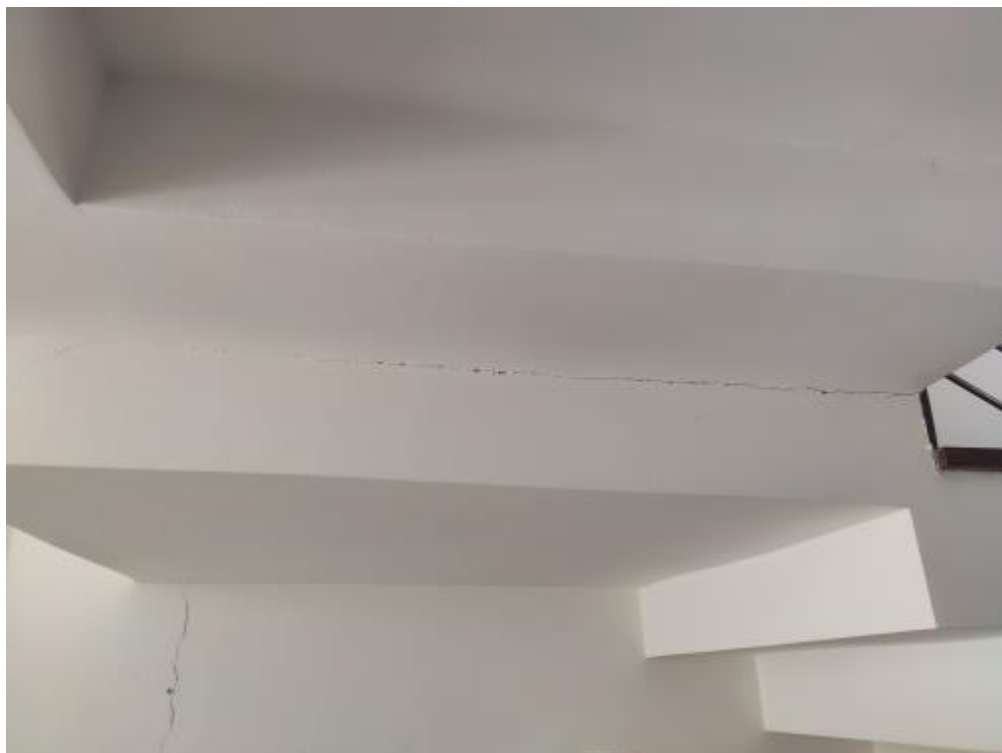
Foto 3 – Fissura abaixo da escada
