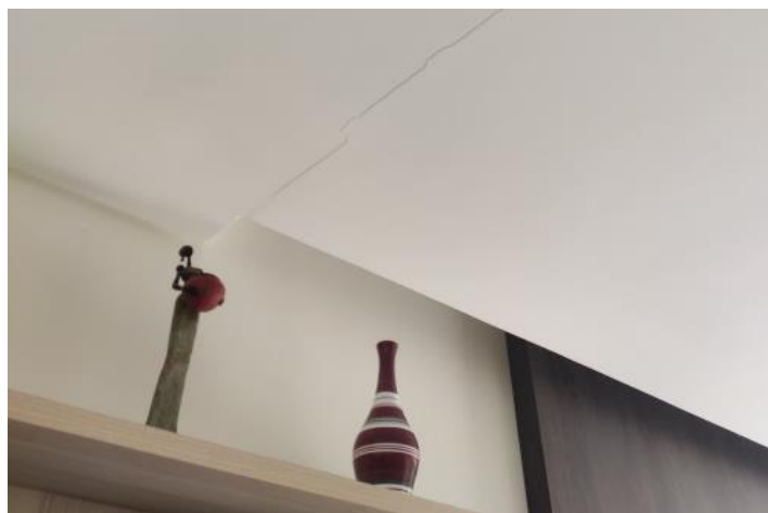
Foto 8 – Fissura na sala de estar/TV
