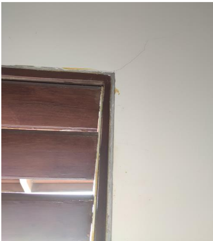
Foto 12 – Fissura na parede interna do quarto do casal
