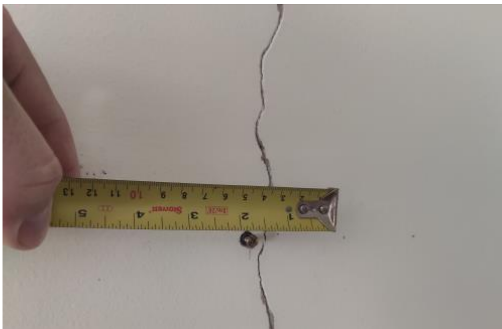
Foto 2 – Medição da largura da fissura
