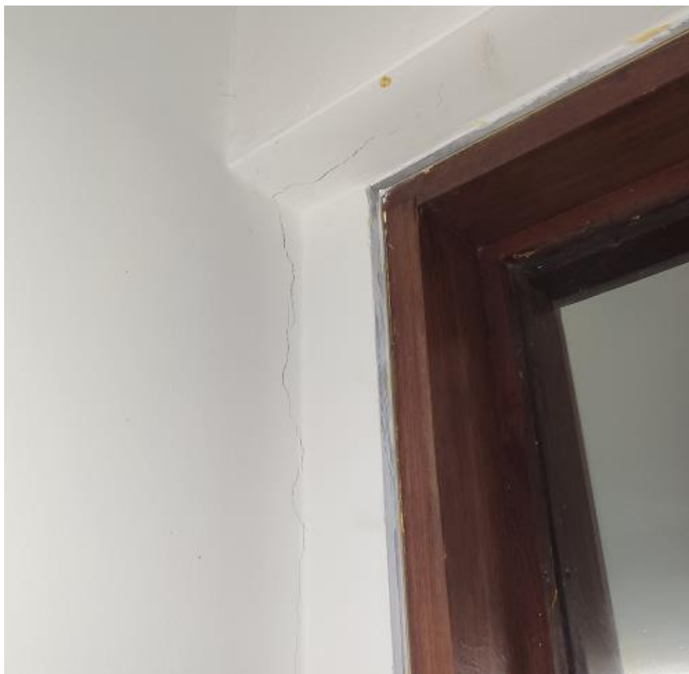
Foto 9 – Fissura no quarto
