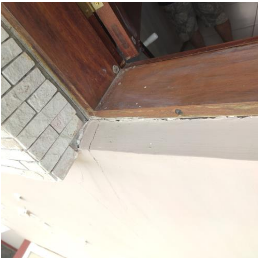
Foto 11 – Fissura no quarto acima do balanço (visão externa)
