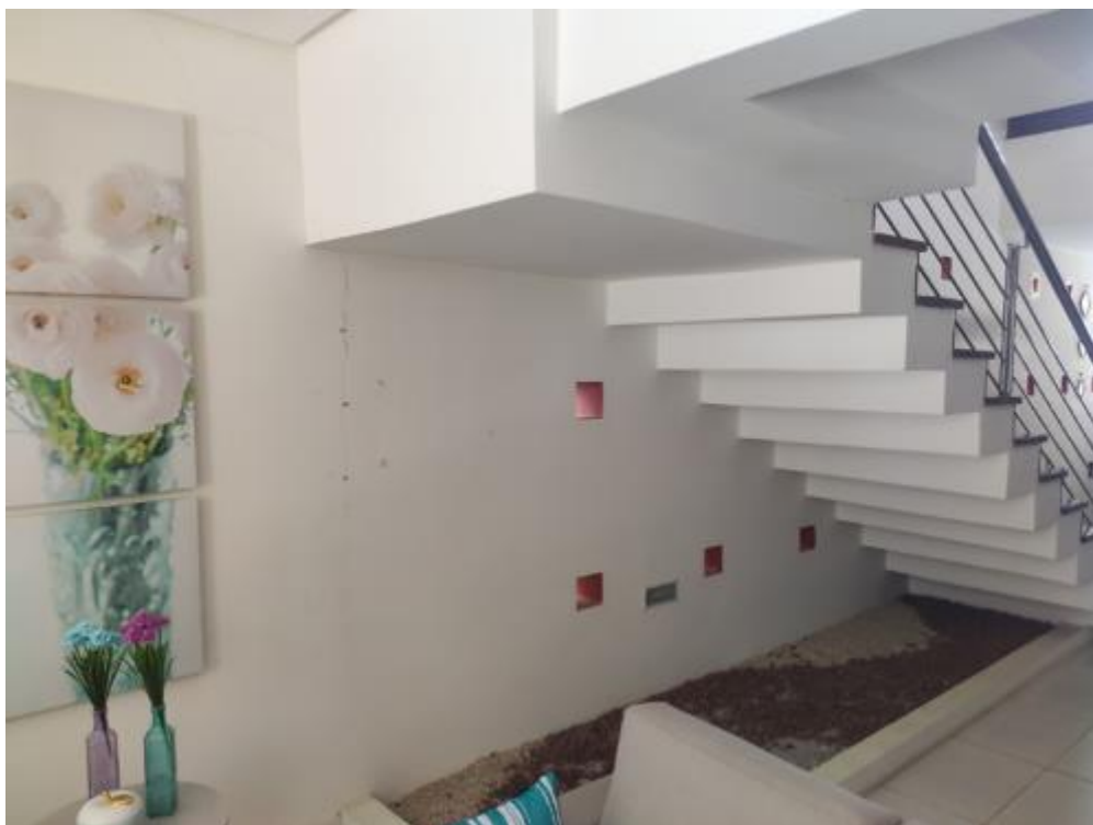
Foto 1 – Fissura na sala de estar/TV
