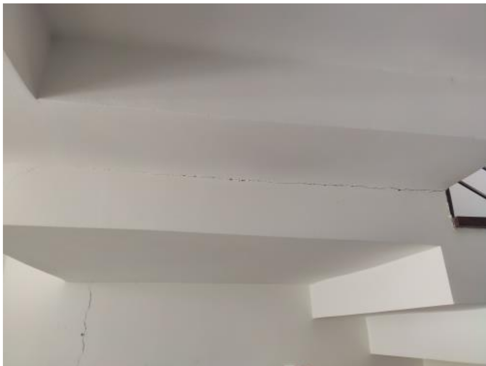
Foto 3 – Fissura abaixo da escada
