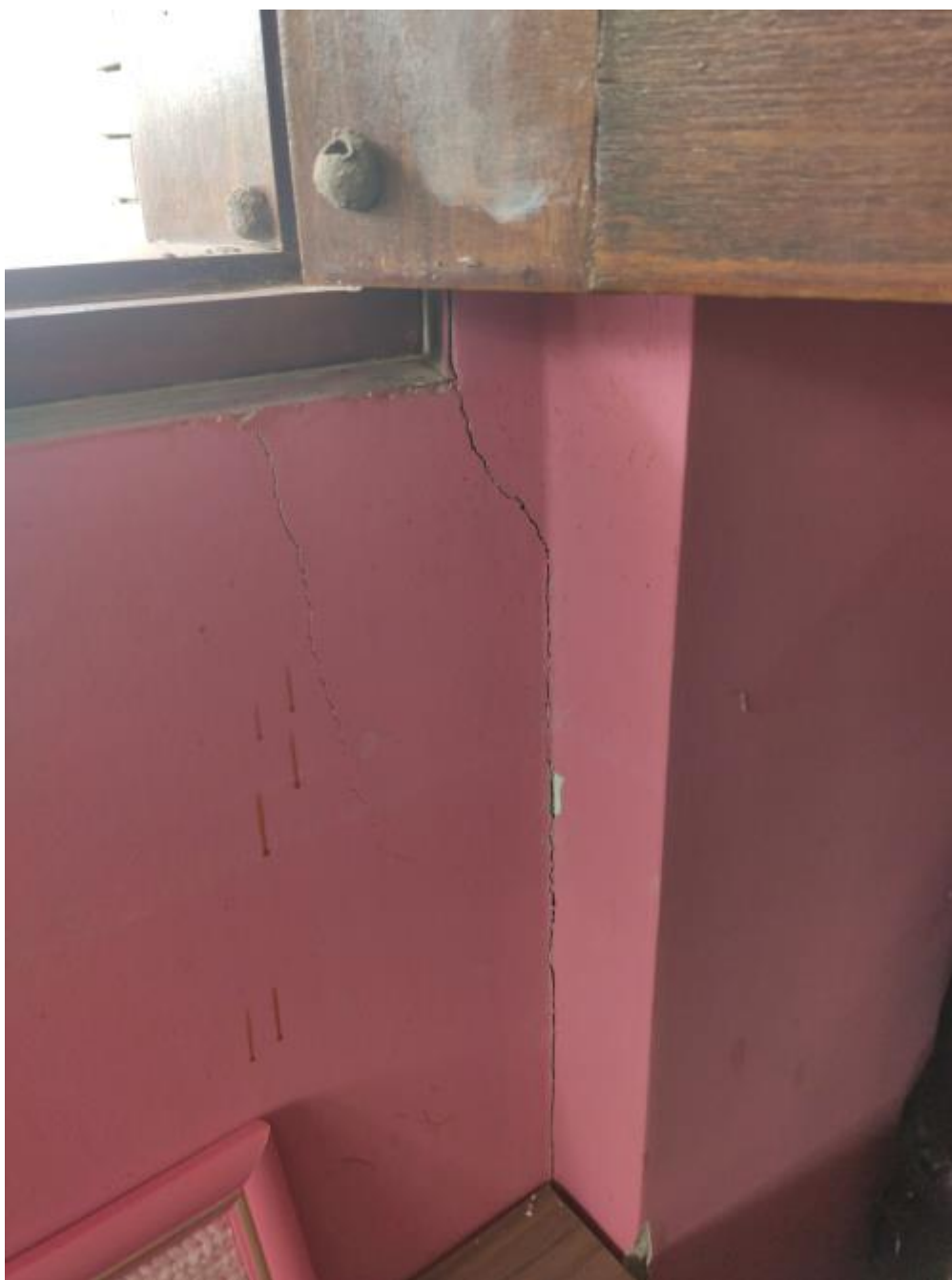
Foto 10 – Fissura no quarto acima do balanço (visão interna)
