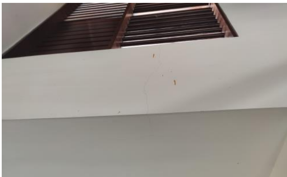
Foto 5 – Fissura na sala, abaixo da janela
