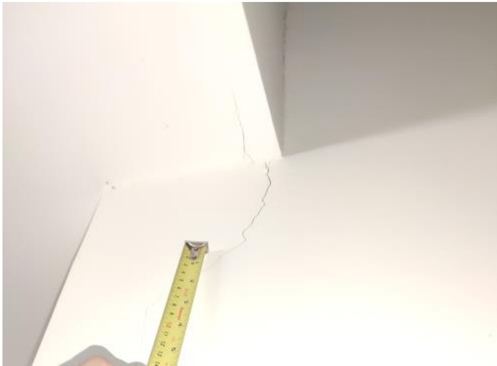
Figura 7 – Mesma fissura sendo medida
